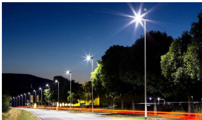
Gambar 2. Penerangan Jalan Umum (PJU)
